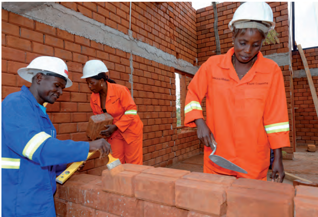
Techniques d'éco-construction de maisons, dans le cadre du programme de l'OIT pour des emplois verts
